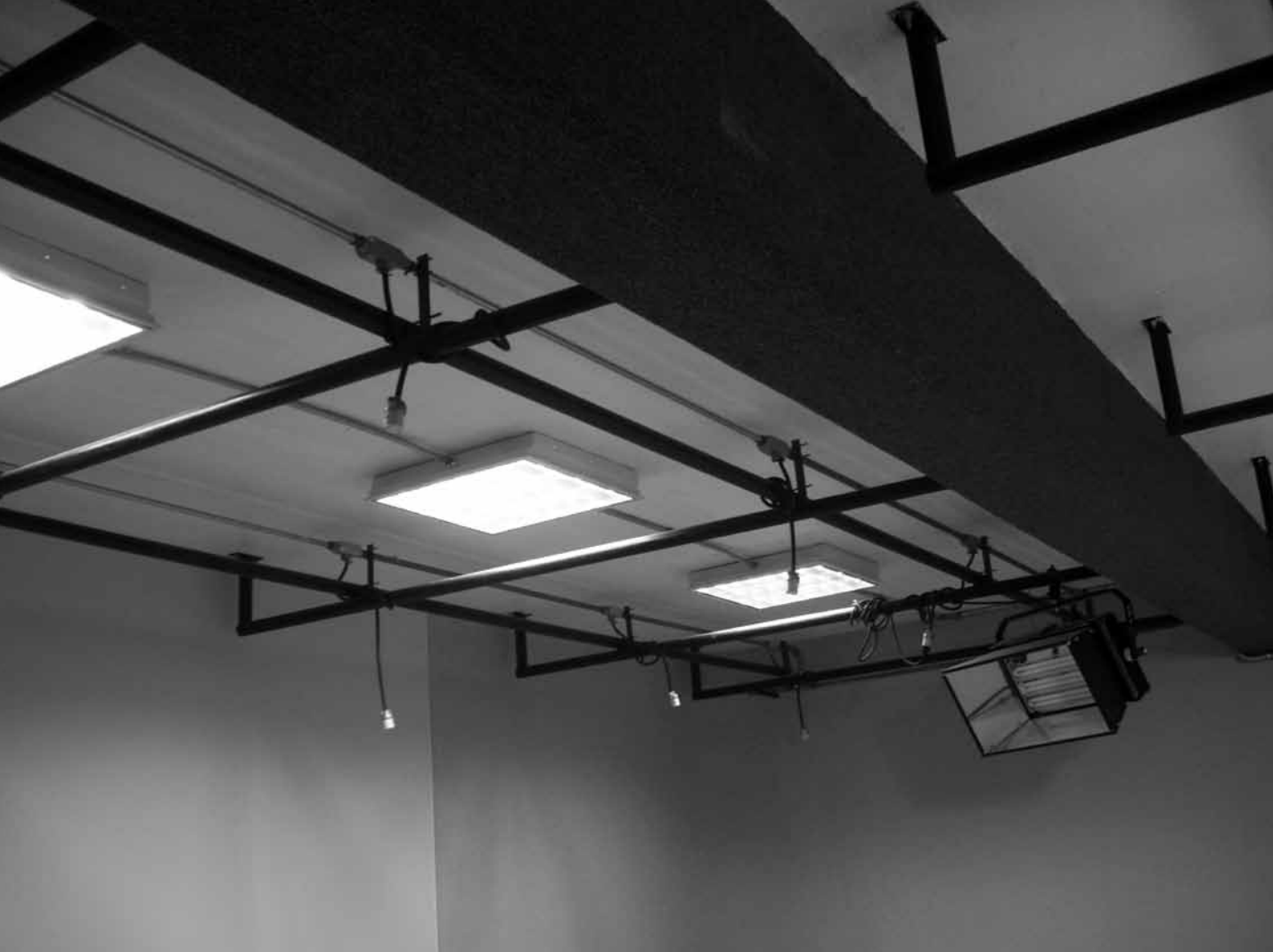
Fig. 2.18 Parrillas en la parte superior del foro sobre las que se sostienen las unidades de iluminación (aquí apagadas). Las lámparas encendidas son las luces de trabajo.
