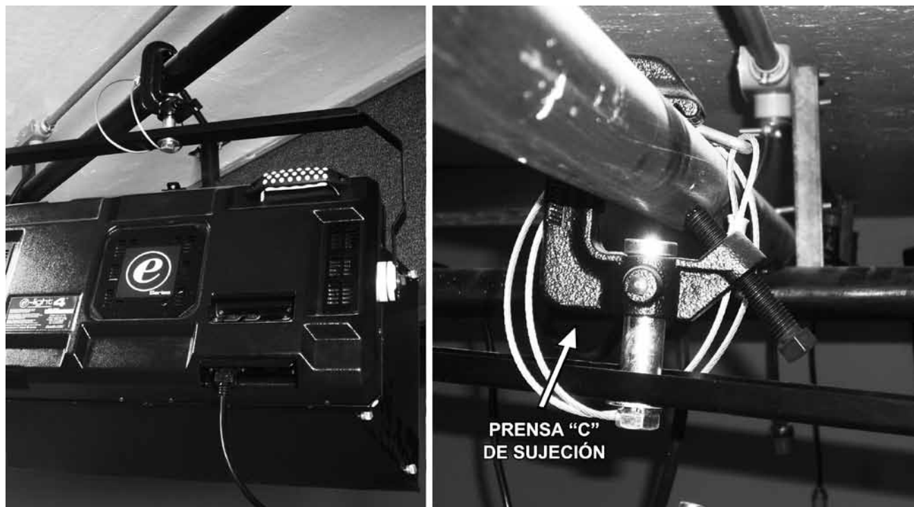
Fig. 4.13. Luminaria sostenida en la estructura tubular de la parrilla de iluminación mediante una prensa tipo “C”
