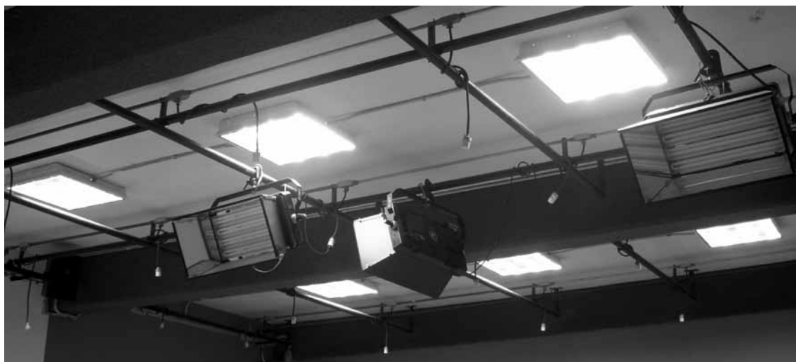
Fig. 4.10 Luces de trabajo, fijadas a la bóveda (encendidas), y luces de producción, sujetas a la estructura tubular o parrilla de iluminación (apagadas).
