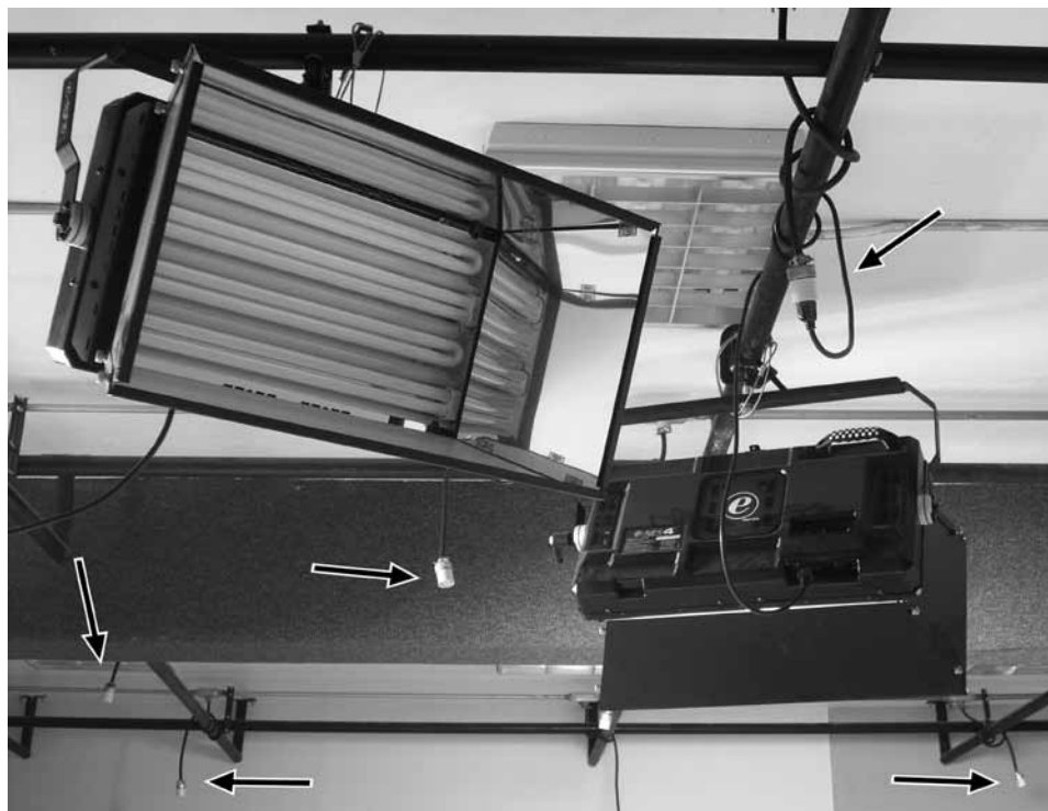
Fig. 4.9 Las flechas muestran algunos de los múltiples contactos para las luces, sobre la parrilla para iluminación del Foro
